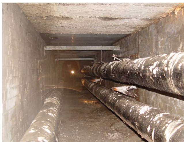
Leidingkanaal in Schaarsbergen. De geïsoleerde verwarmingsleidingen in dit tracé zijn nog in gebruik. Op de achtergrond: Vilmar Dijkstra.
